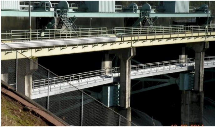
Fig. 5. Clackamas Hydro Project- Estacada, OR
